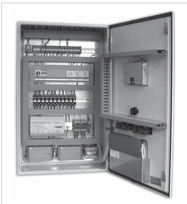
Рис. L5: Панель зонального управления, вид изнутри
