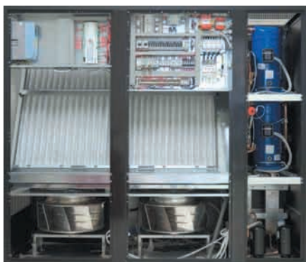
Рис. 2. Агрегат со снятыми инспекционными панелями
